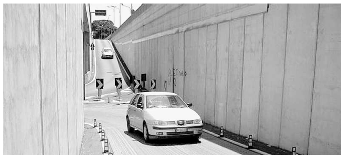
La parte del sottopasso che sbucca verso l'Aurelia danneggiata da febbraio scorso
